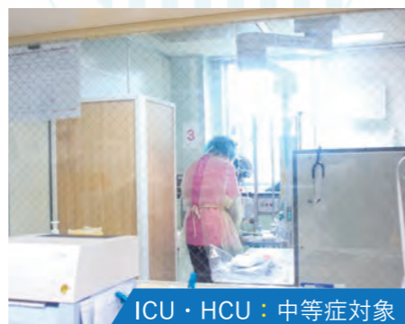
HCU：陰圧装置を設置
